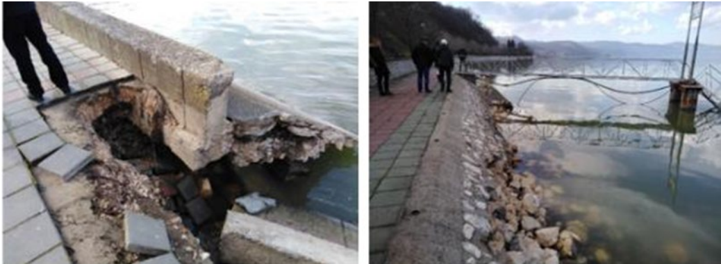
Слика 17. Оштећење обалоутврде у фебруару 2020. године
