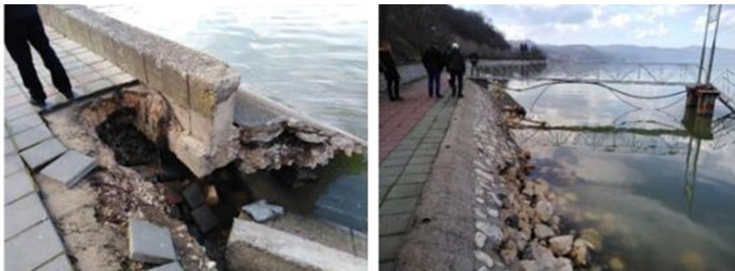
Слика 4. Оштећење обалоутврде у фебруару 2020. године
